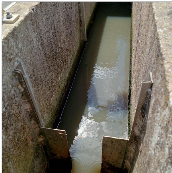
FIGURE 15 – STATION D'EPURATION DES ABRAIES – L'HERBERGEMENT : OBSERVATION DU REJET EN SORTIE DU CANAL VENTURI LORS DE L'EVENEMENT DE POLLUTION
