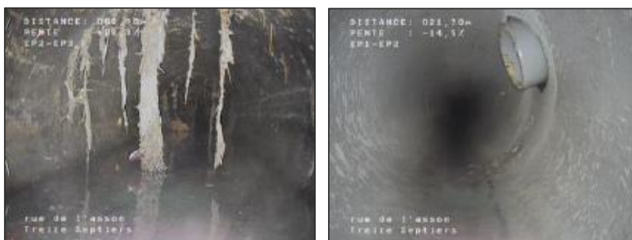
FIGURE 13 – EXEMPLES DE RESULTATS D'INSPECTION TELEVESEE DES RESEAUX (ITV)
